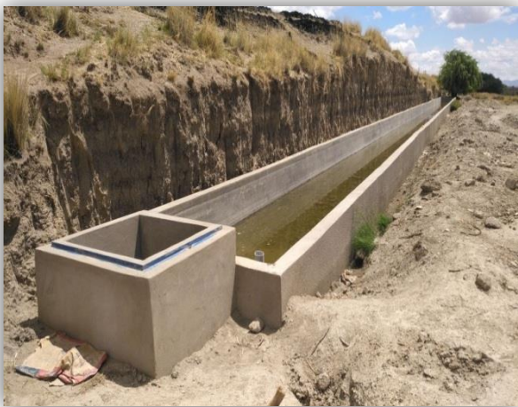
TANQUE DE ALMACENAMIENTO
